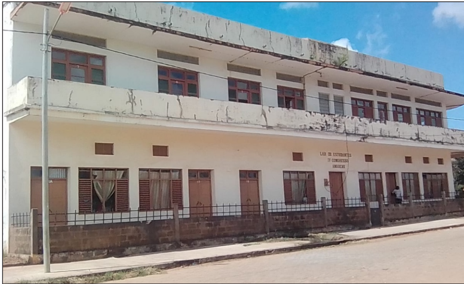
Vista frontal do Edifício - Lar dos Estudantes de Angoche, na Província de Nampula.
